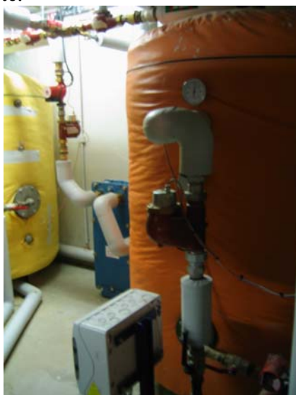
Figure 87 : Ballons de stockage
